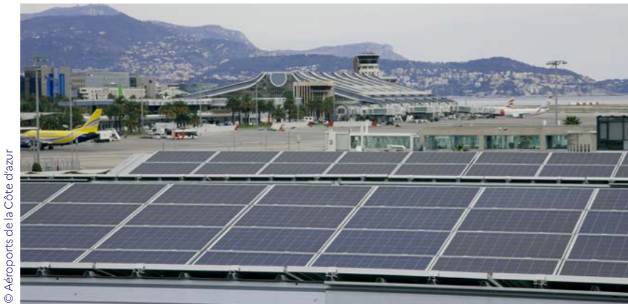
Parkings recouverts de photovoltaïques; aéroport de Nice
