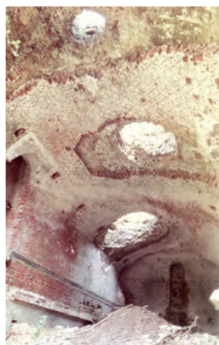
Impact d'obus de gros calibre sur le fort de Cerfontaine.
