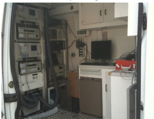
Baie d'analyseurs de gaz
