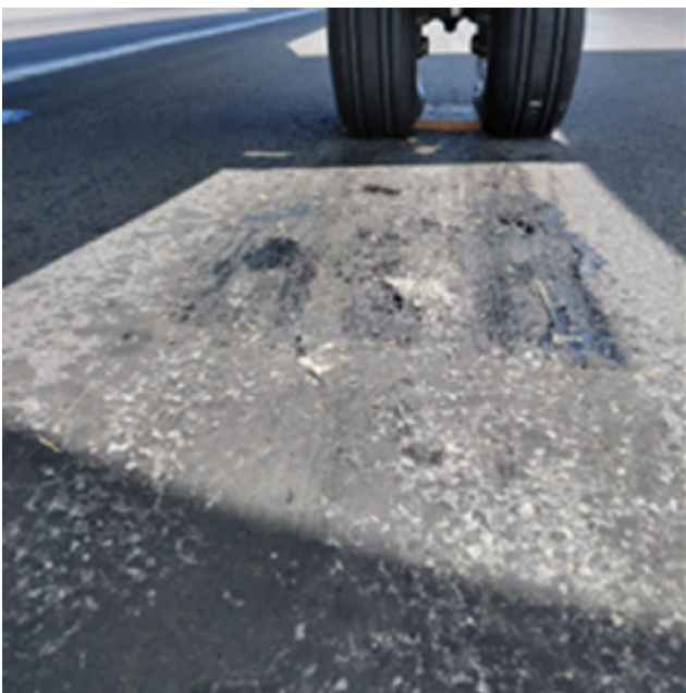
Détérioration de chaussée lors d'une opération de maintenance sur un aéronef immobilisé sur piste
