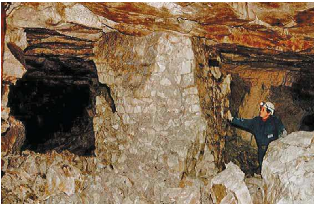
Pilier maçonné dégradé (INERIS)
