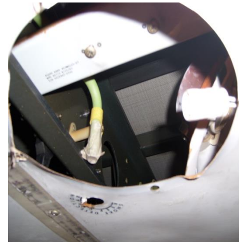
Détecteur de fumée obstrué
