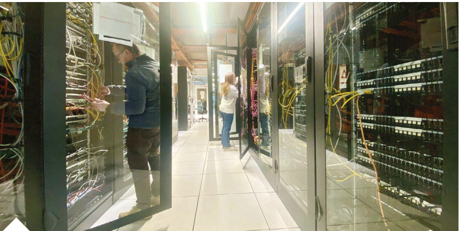
Nouvelle salle technique à Marseille-Provence.
