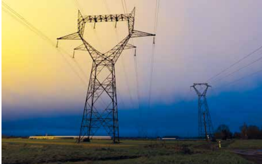
Pylônes électriques THT en sortie du CNPE de Chinon © Arnaud Bouissou/METL-MEDDE
