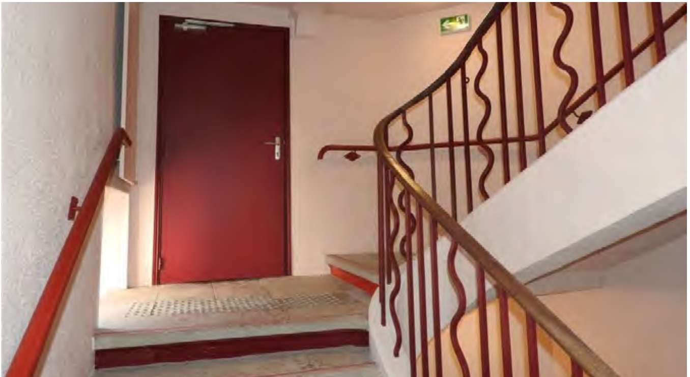
Mise en conformité des escaliers : bande d'éveil à la vigilance, mains courantes et contraste couleurs
