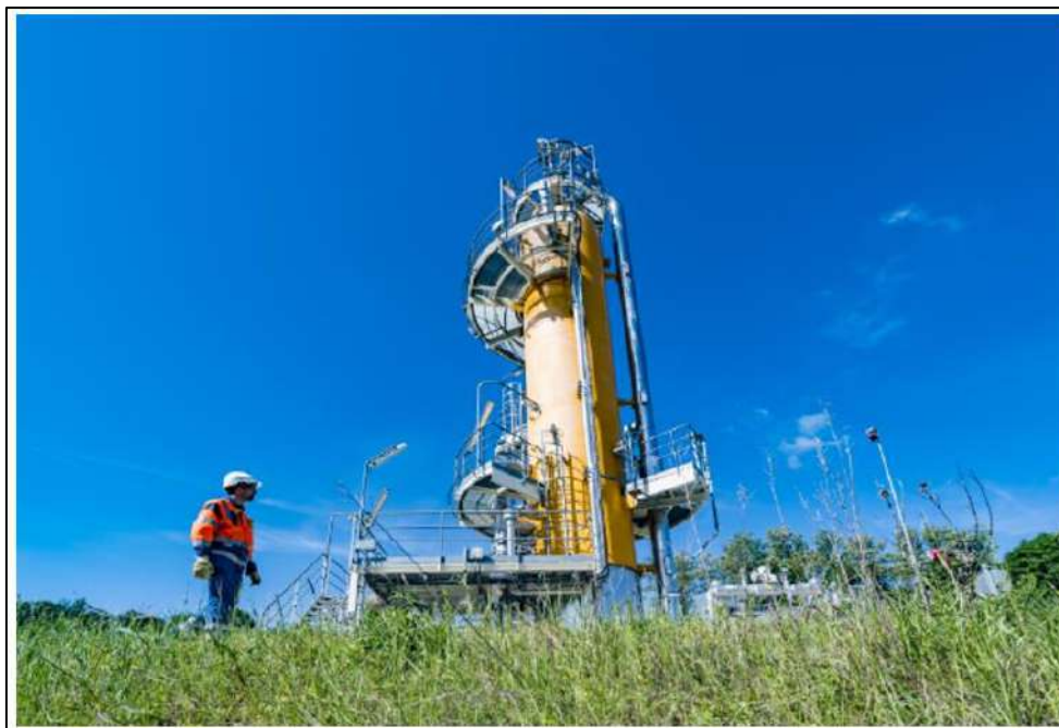
Figure 1 : Photo d'une installation de surface d'un site de stockage Storengy
