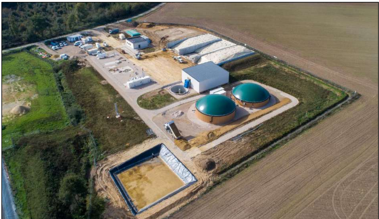
Figure 14 : Vue du projet METHYCENTRE en fin de construction – Octobre 2022
