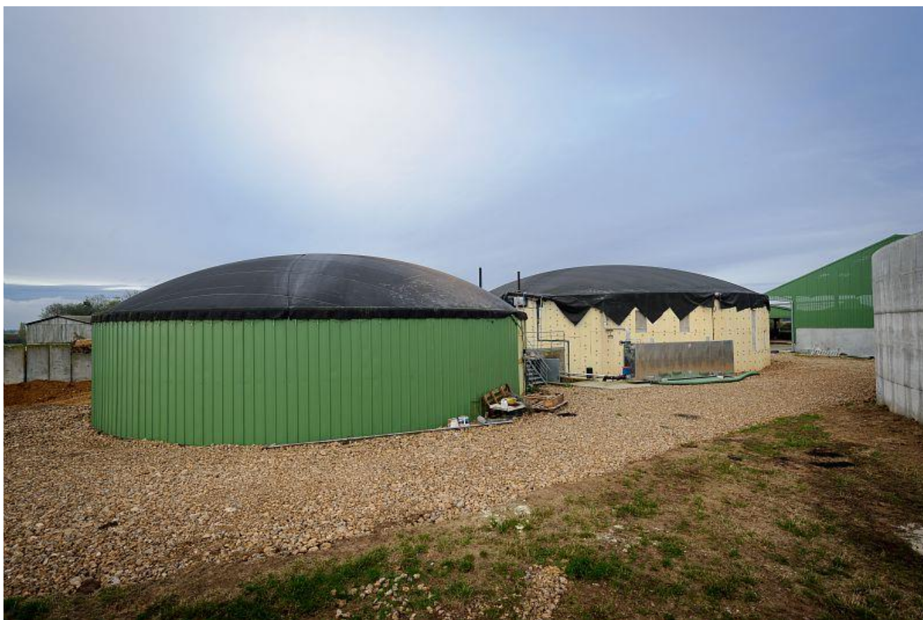
Ferme possédant une unité de méthanisation (Orne - Moussonvilliers). Crédit : Arnaud Bouissou / Terra
