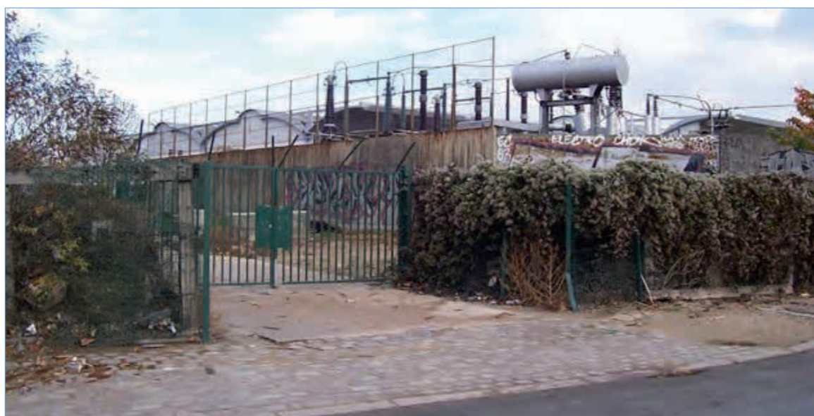
Photographie 32 : vue sur la sous-station depuis la rue du Commandant Rolland.
