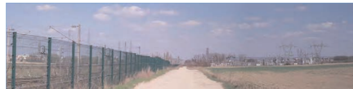
Photographie 29 : sous-station électrique de Mitry en bordure de la voie ferrée.
