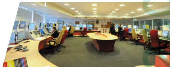
Salle de supervision technique.
