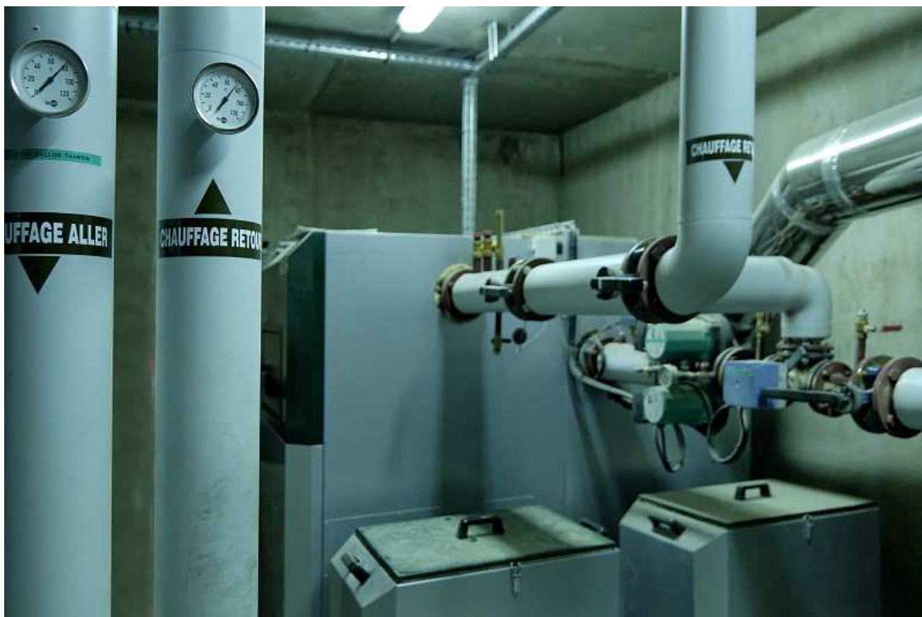
Chaudière à granulés. Crédit : Laurent Mignaux / Terra
