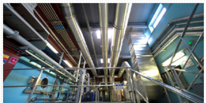
Collecteurs d'eaux usées
