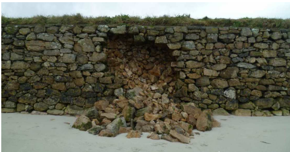
Dégâts sur la digue du Curnic à Guissény (29) à la suite de la tempête survenue du 2 au 5 janvier 2014
