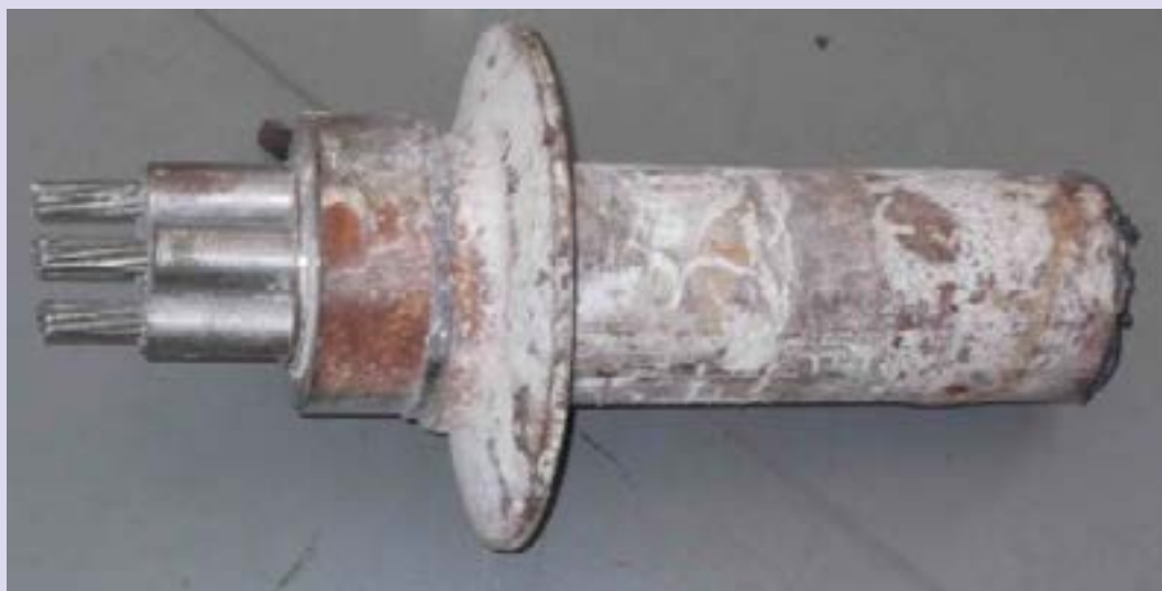
Ancrage de câble de précontrainte extraite d'un pont
