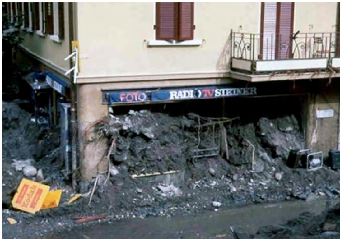
Illustration 53 : pénétration de la crue par les vitrines du bâtiment (©Roberto Loat OFEG).
