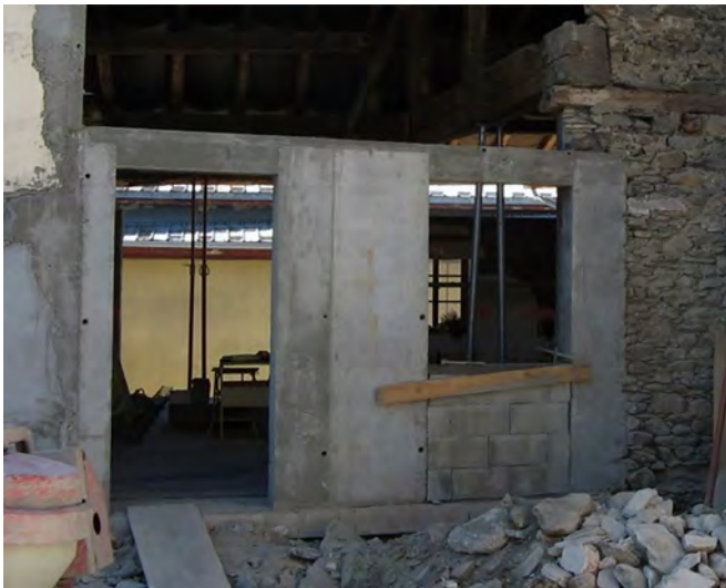
Illustration 49 : réalisation de liaisons lors de la réhabilitation d'un bâtiment ancien (©SEPIA Conseils).
