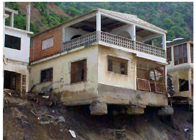
Illustration 47 : bâtiment avec liaisons et chaînages, ayant subi un affouillement important sans dislocation de la structure (©CEMAGREF DR).
