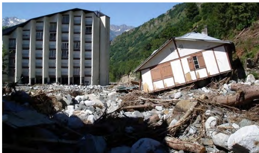
Illustration 48 : maison sans liaison ni chaînage, disloquée par des affouillements sous les fondations (source : ONF-RTM).
