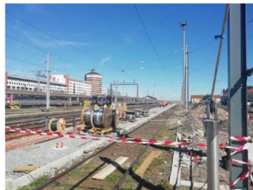
Passage alimentation électrique et canalisations
