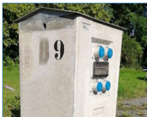
Borne d'accès à l'eau installée sur l'aire d'Orthez
