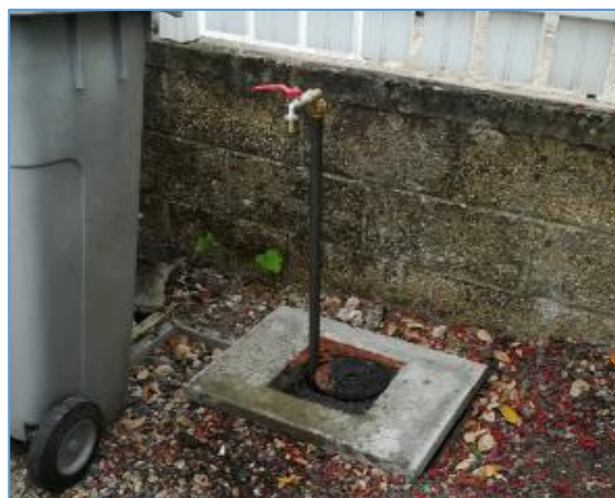
Robinet d'eau potable installé en bordure de propriété
