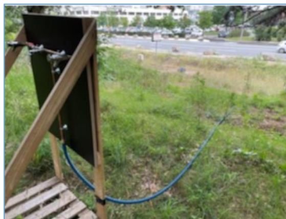
Point d'accès à l'eau potable installé en bordure de squat
